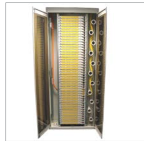
5b Optical distribution frame (ODF)
