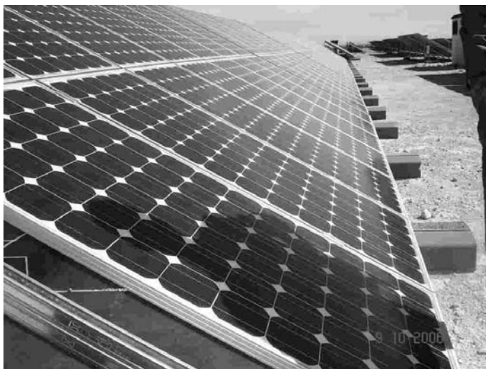
Instalación solar con paneles fijos
